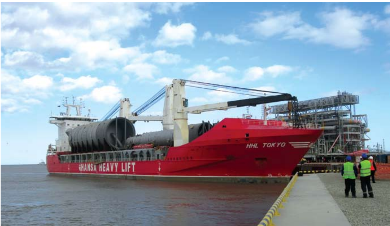
ПЕРЕГРУЗКА КРУПНОГАБАРИТНЫХ МОДУЛЕЙ НА ПРИЧАЛАХ № 5, № 6 В МОРСКОМ ПОРТУ В РАЙОНЕ ПОСЕЛКА САБЕТТА НА ПОЛУОСТРОВЕ ЯМАЛ
